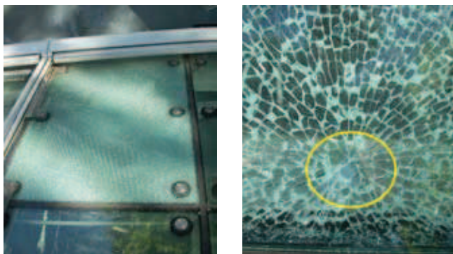
Rys. 3. Uszkodzenie tafli szklanej zadaszenia budynku, spowodowane zmianą objętości inkluzji siarczku niklu
