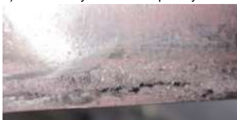
c) uszkodzenia na krawędzi kształtownika
