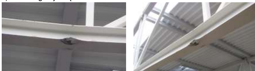
d) miejscowe i globalne deformacje pasa dolnego uszkodzonej kratownicy
