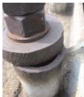
d) brak szczelności połączeń
