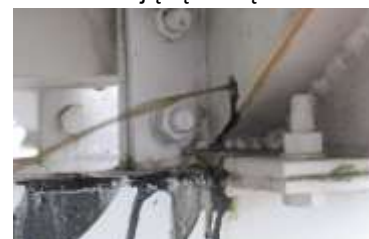
d) woda w kształtownikach
