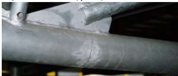
a) pęknięcie pasa dolnego w obrębie węzła
