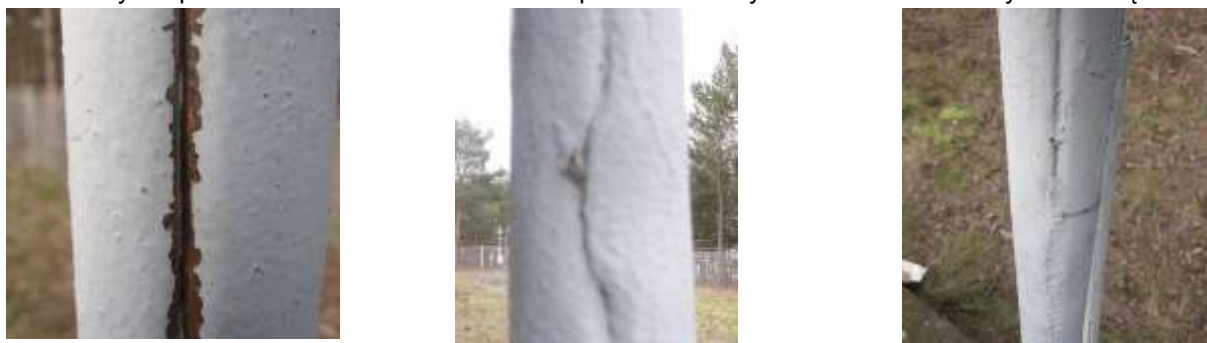
Rys. 7. Rura w miejscu szwu podłużnego
