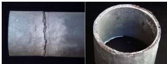
b) zniszczone połączenie rury pasa dolnego
