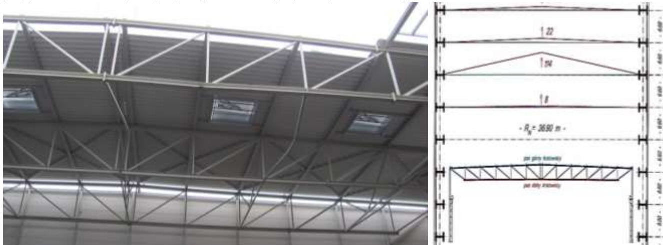
a) Widok zdeformowanej części hali
