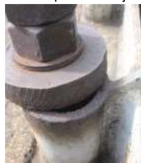
d) brak szczelności połączeń
