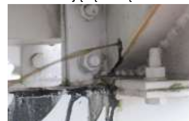
d) woda w kształtownikach
