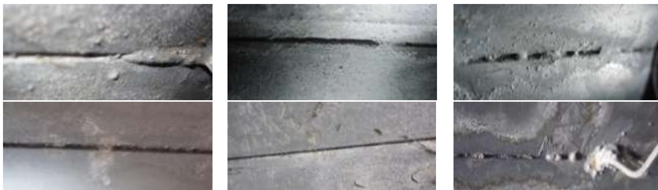
Rys. 6. Przykłady wadliwie wykonanych spoin czołowych łączących połówki segmentów
